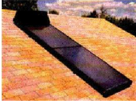
Fig. 10.5 Colectores de baja temperatura
